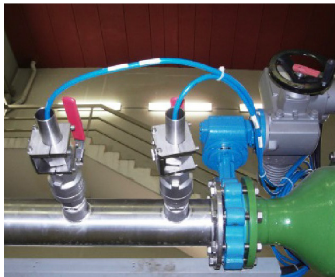
Misura della portata di alimentazione acqua potabile. Misura in un tubo pieno a singola traccia
