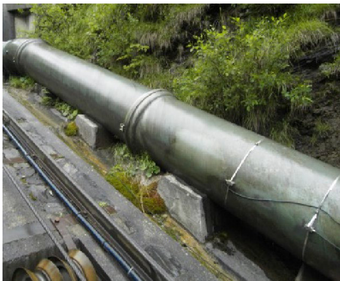
Misura di portata/ingresso turbina con sensori a ultrasuoni clamp-on
